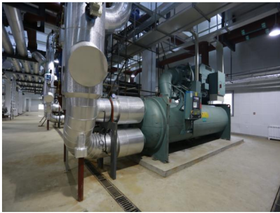
冷水机组实拍图
