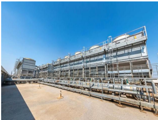
冷却塔实拍图
