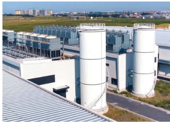
蓄冷罐实拍图
